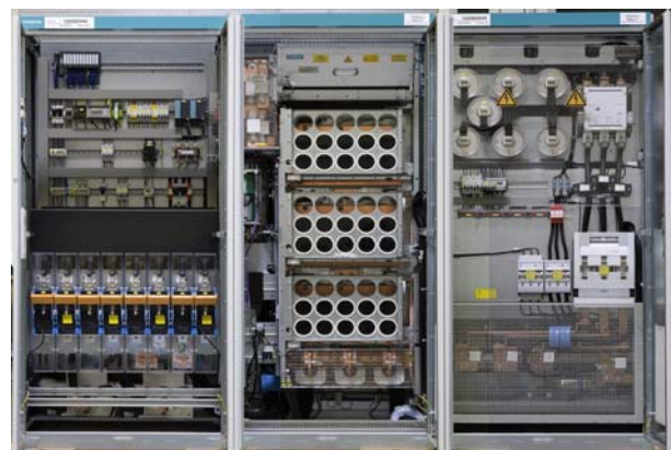
Bild 2 Blick ins Innere eines PV- Wechselrichters
