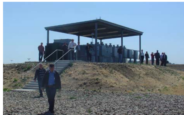
Bild 1 Aufstellung in Kalifornien (1 MWp)
