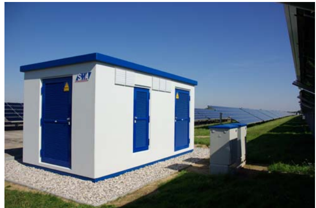
Abbildung 7: Wechselrichterstation SC 1000 MV mit DC-Hauptverteilern [2]
